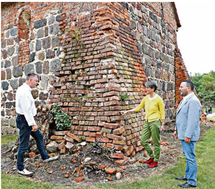
Die Stützpfeiler am Westwerk erfüllen ihren Zweck nur noch bedingt. Carolin Goebel vom Architekturbüro erklärt das Sanierungskonzept.
